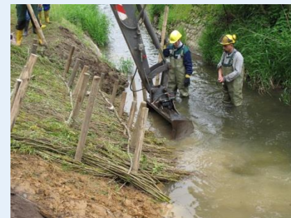
Naturnaher Hochwasserschutz an der Eula, © LFJULG
