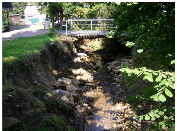
Böschungsschaden am Struppenbach (Foto ECOSYSTEM SAXONIA 2010)
